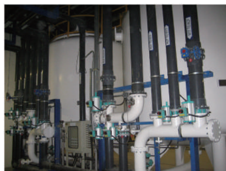
純水設備配管 Demineralization
