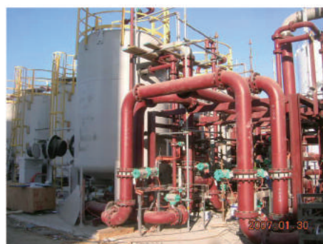
純水設備配管 Demineralization
