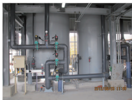
儲槽配管 Pipes
