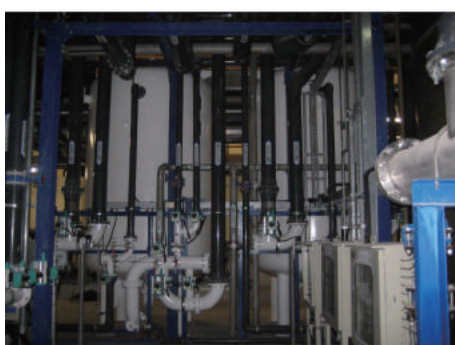
純水設備配管 Demineralization
