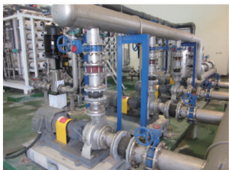
泵浦設施 Pumps
