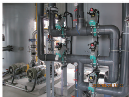
儲槽配管 Pipes
