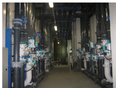
配管設施 Pipes
