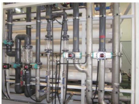
RO 逆滲透設備配管 Reverse Osmosis
